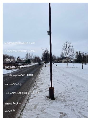
13 pav. Didžiosios Kabiškės, Nemenčinės ir Tvenkinio g. sankryža, ID 12
